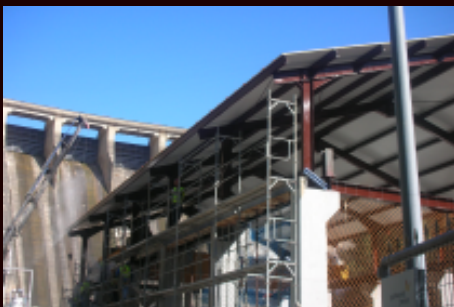
Central Hidroeléctrica Peares II (Orense)
