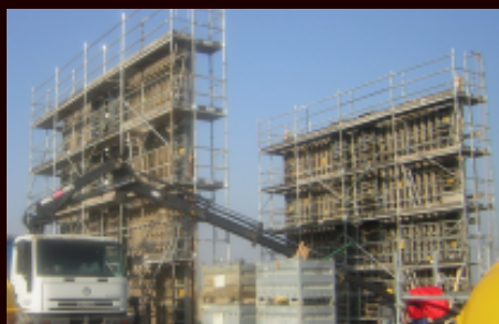
Subestación eléctrica El Palmar 400 kV (Murcia)
